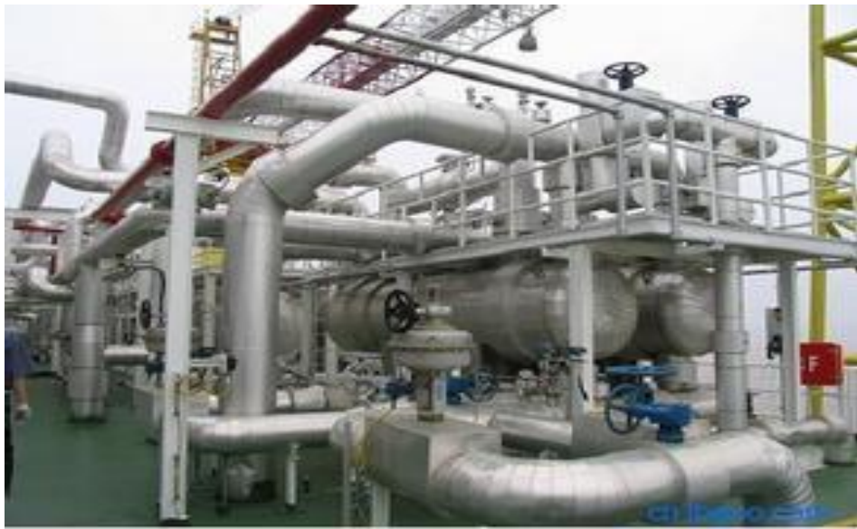
图 10：工业压力管道
