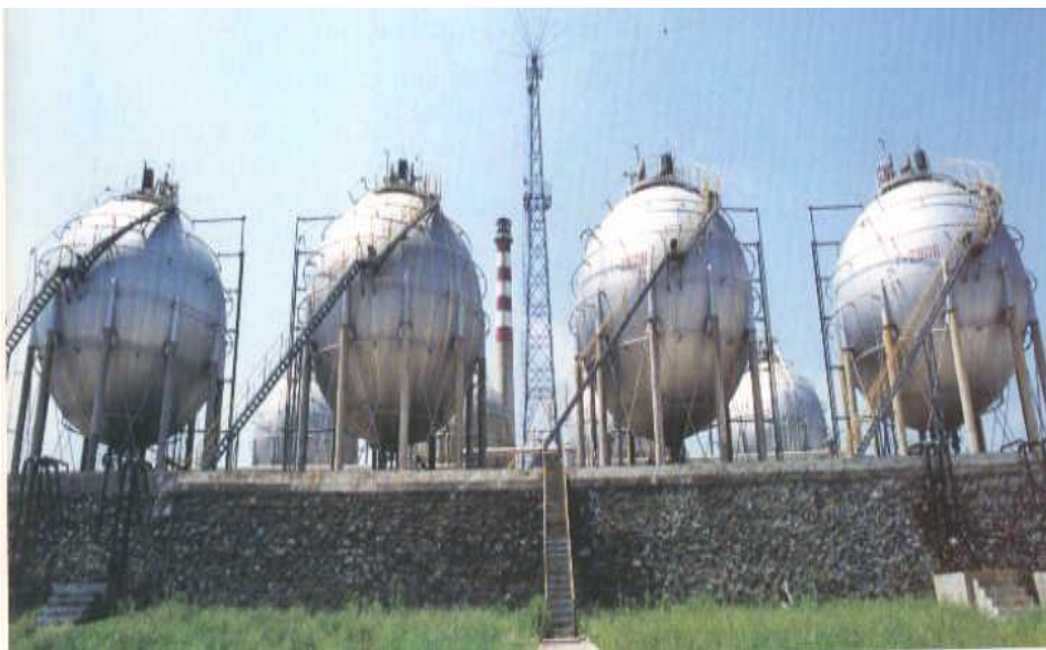
图 7: 固定式压力容器 (球形储罐)
