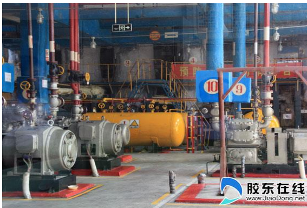
图 23：氨制冷用压力容器压力管道
