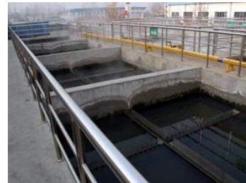
(f) 污水处理池
