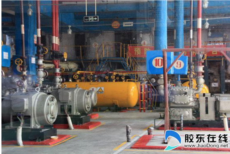
图 22：氨制冷用压力容器压力管道
