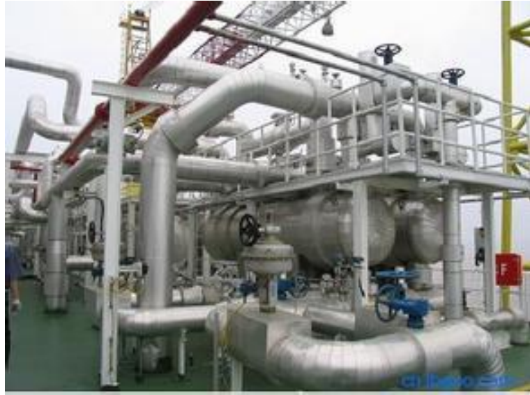
图 9：工业压力管道
