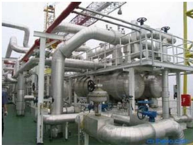
图 9：工业压力管道
