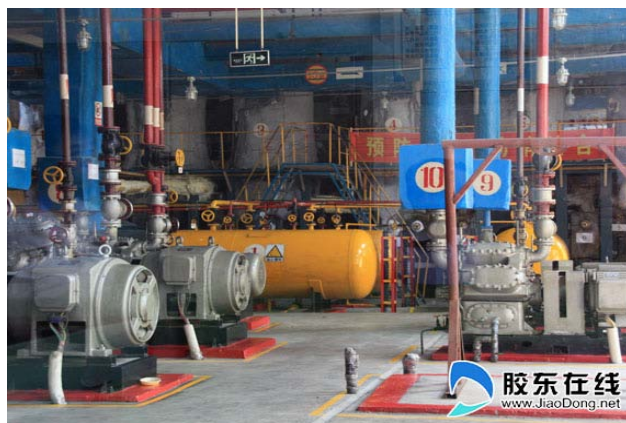
图 21：氨制冷用压力容器压力管道
