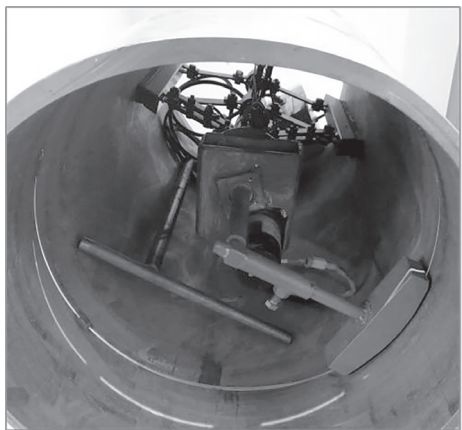
图3 高合金钢管道自动充氩装置
