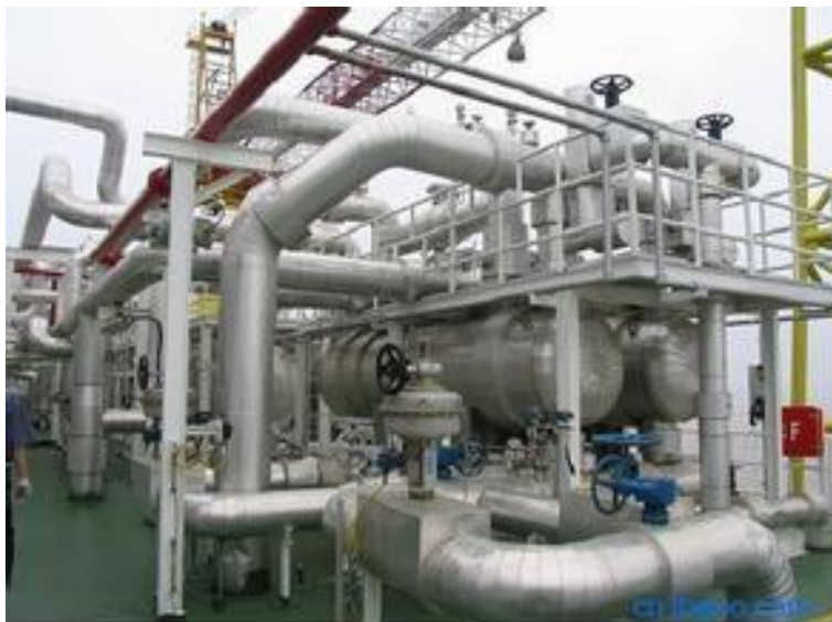
图 9：工业压力管道
